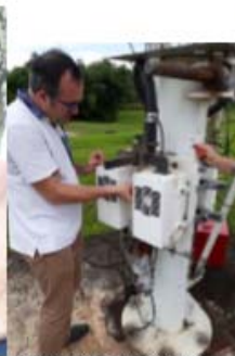
Instalación cooler IBUCs
