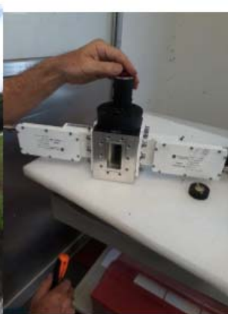
Verificación componentes Rx antenna
